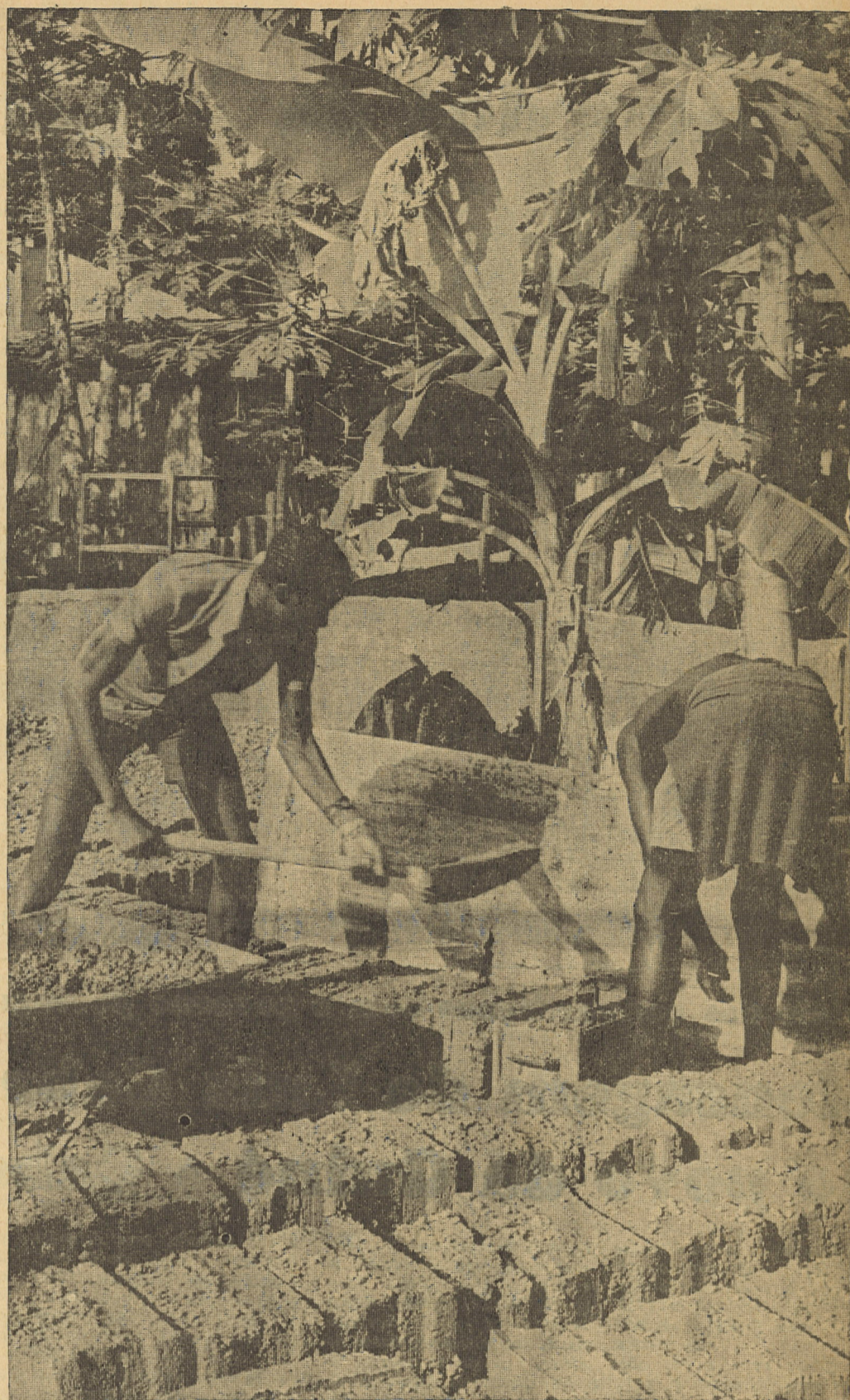
Nova sede do Comité de Tchada de acordo com os planos de urbanização
