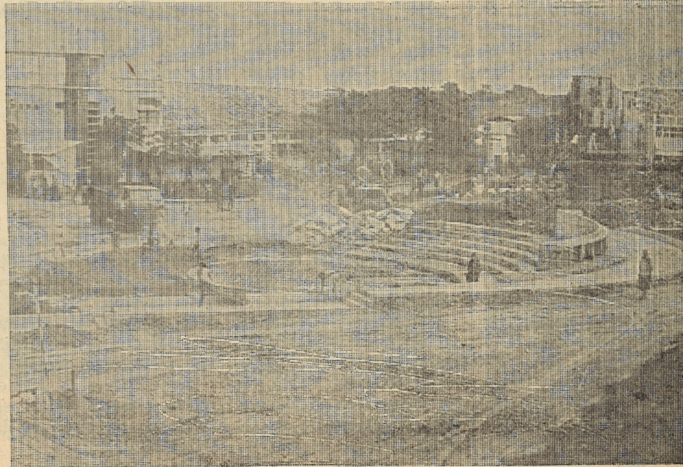
Imagem das obras na Praça dos Mártires do Colonialismo, podendo-se ver ao fundo o Monumento em fase bastante avançada
